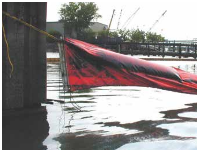
▲ Рис. 16: Применение недостаточной длины якорной оттяжки привело к подвешиванию бона при низкой воде, что позволило нефти протекать под бонем. Необходима регулярная корректировка длины оттяжек для поддержания эффективного положения бона на протяжении всего приливно-отливного цикла. В данном примере скользящая постановка на якорь была бы более эффективной.
