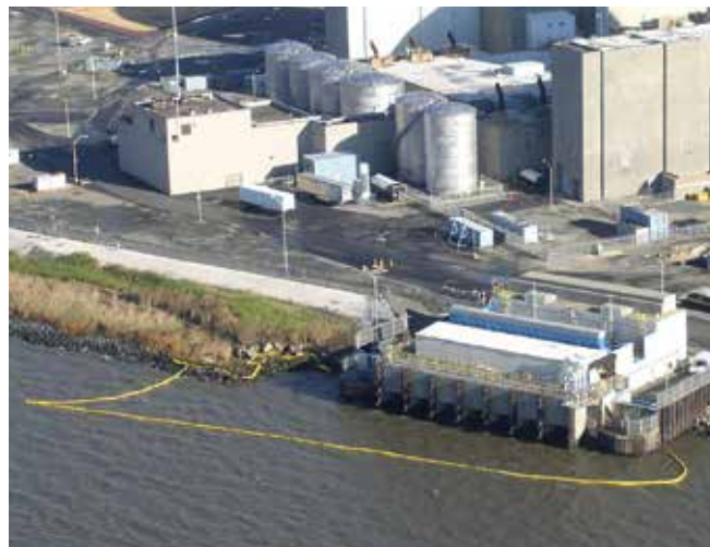
▲ Рис. 13: Бон-занавес, развернутый перед водозаборным сооружением охлаждающей воды для электростанции.
