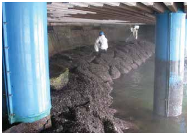
▲ Рис. 31: Доступ в пространство под пристанями может быть затруднен и опасен для персонала ввиду ограниченного пространства над головой и отсутствия вентиляции.
